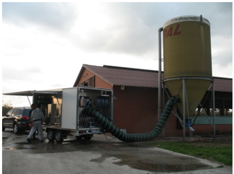
Bild 016: Trocknung und Kühlung des Silos
