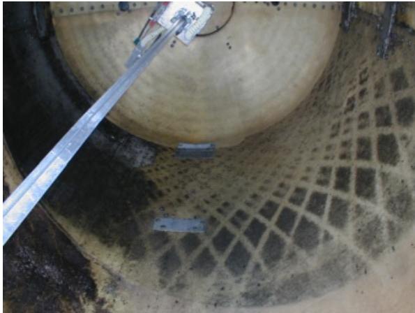
Bild 007: Unsachgemäße Reinigung Rasenwachstum - Effekt Rotierender Waschkopf
