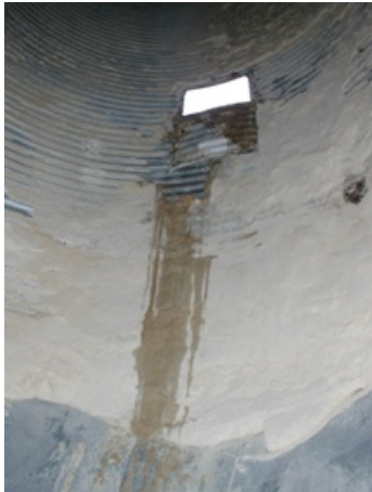
Bild 005: Undichte Luke in 6 Meter Höhe
